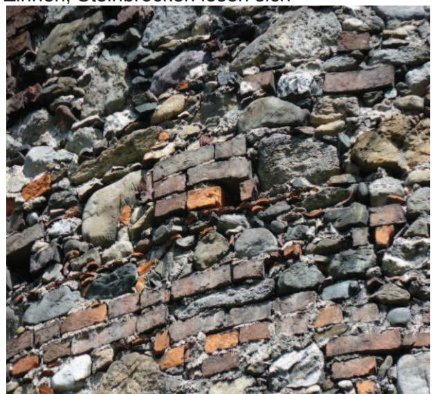
Mauerwerk mit Abplatzungen
