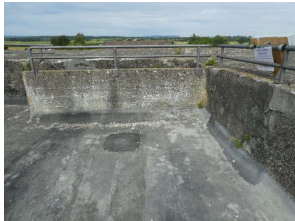
Beschädigung der Bodenbeschichtung umlaufend
