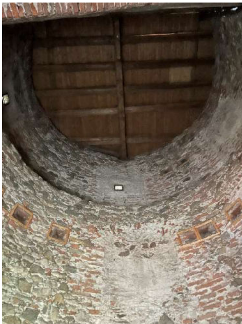
Reste des Putzes erkennbar
