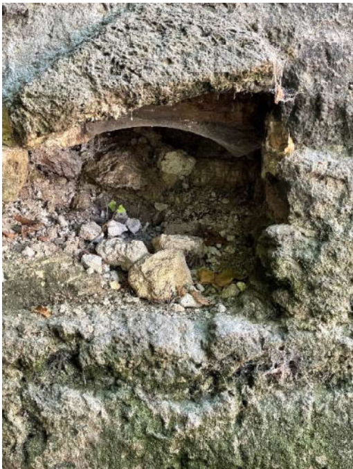
Aushöhlung, Nistplatz im Mauerwerk
