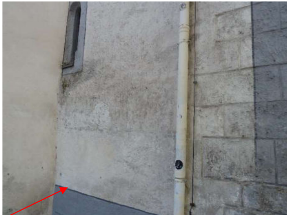
Übergang gestrichen – nicht gestrichen
