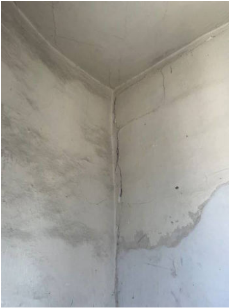
Risse in Zimmerecke
