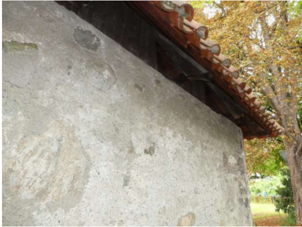
Traufe mit Brettern verschlossen, leichte Abplatzungen im Putz
