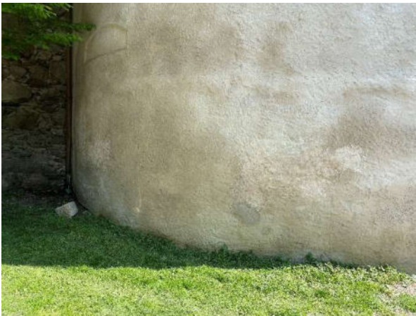
Teilweise feuchter Sockel
