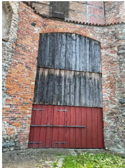
Zugang. Verwitterte Holzschalung
