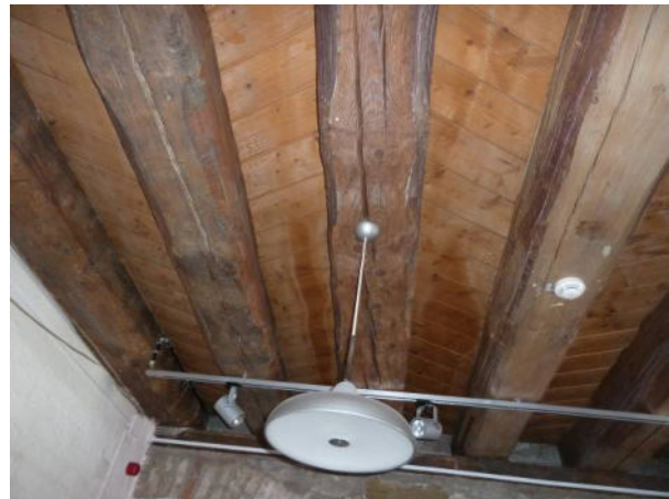
Holzdecke mit Brandschutzanstrich
