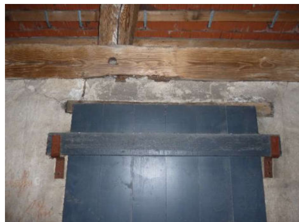
Sturz mit Rissbildung
