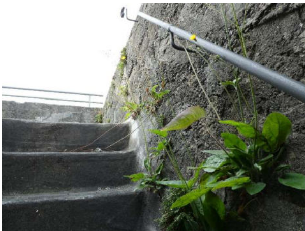
Starker Bewuchs an den Seitenwänden
