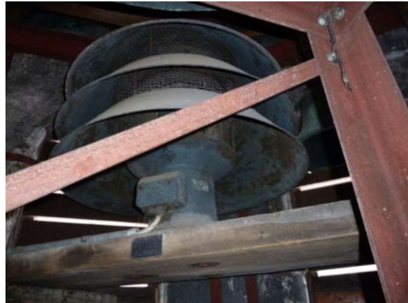
Blick ins DG: Stahlverstärkungen, Sirene
