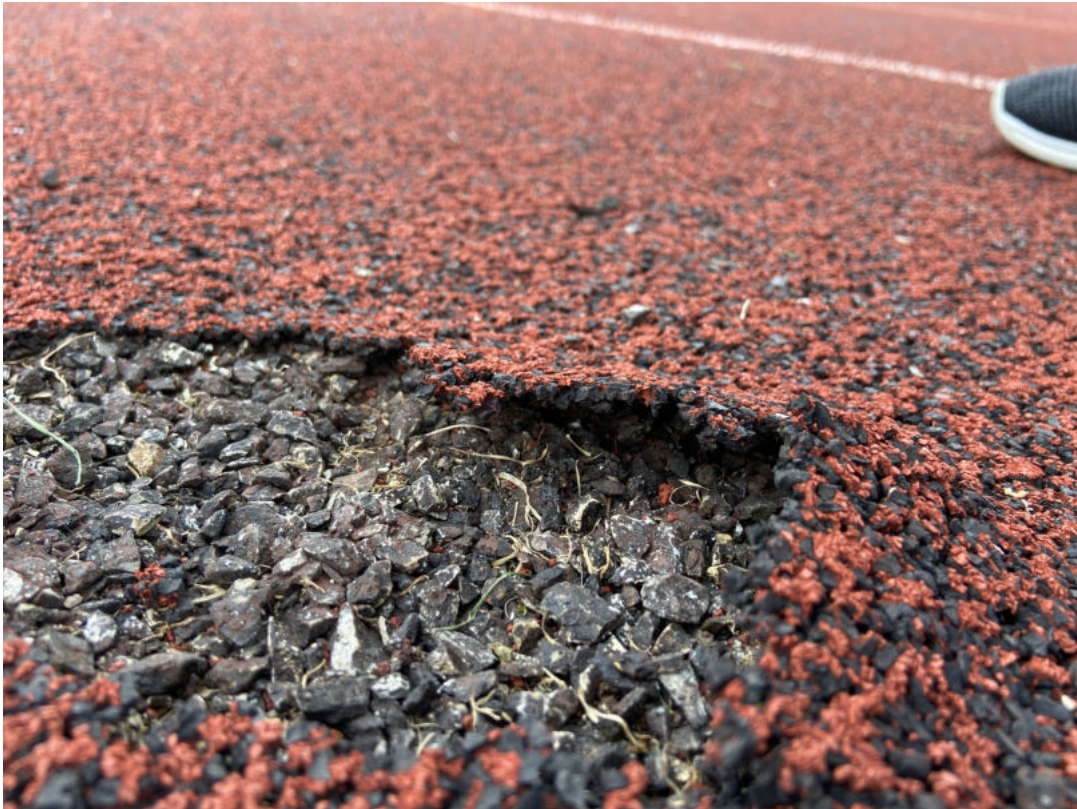
Einbau SOLL >11+3 mm, IST 5 -6 mm
