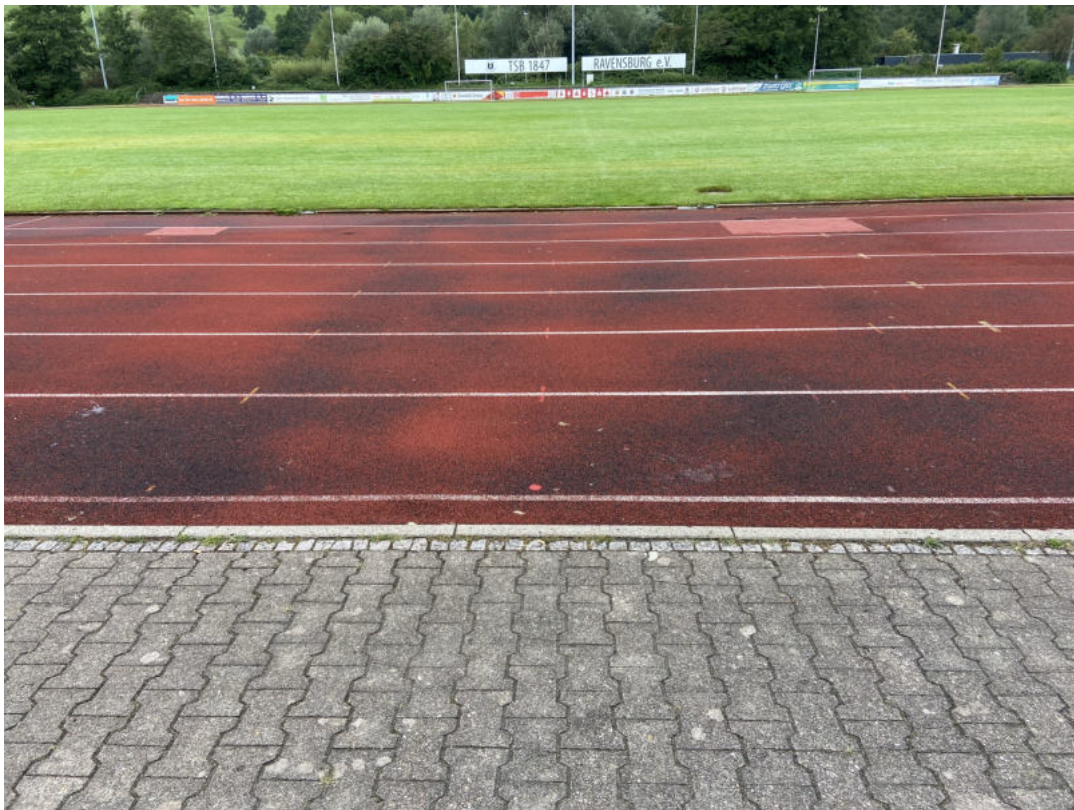
Spritzbeschichtung löst sich durch die Nutzung
