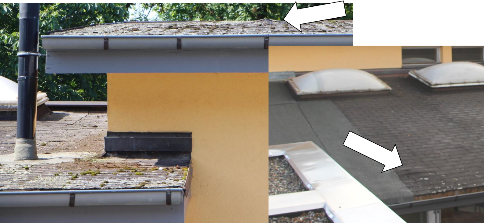
Blasenbildungen Nord- und Süddach auf Grund von Eintrag / Unterkriechen der Dachhaut durch Nässe
