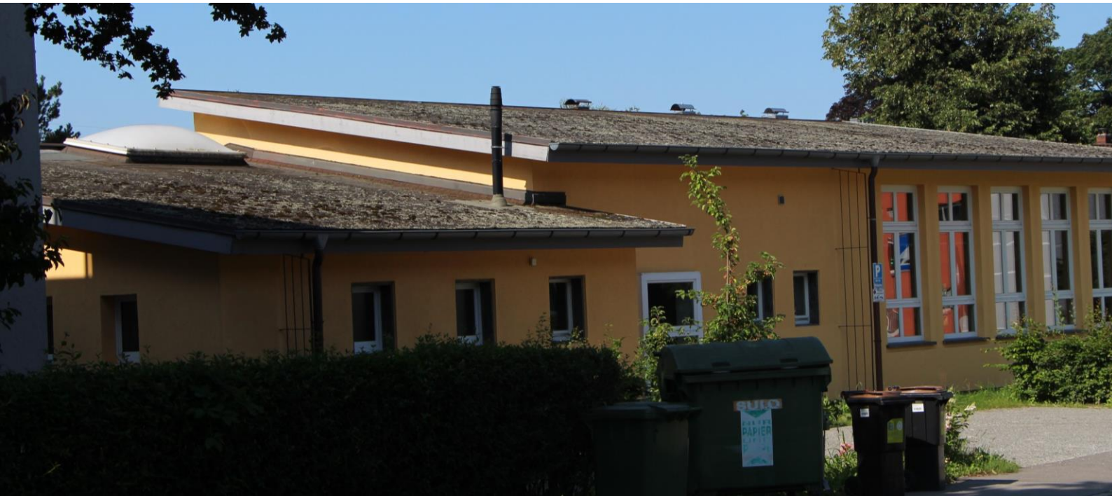
Zerklüftete, spröde Dachhaut, Unterkriechen / Aufschüsseln der Pappschindeln durch Moose, Nässeintrag
