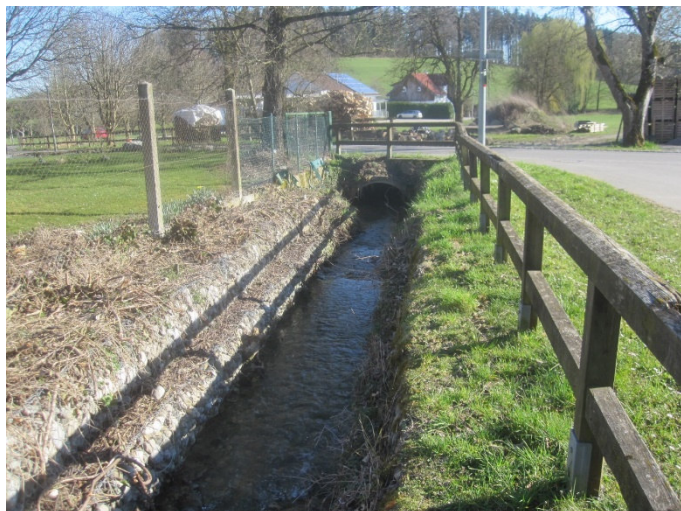
Foto 4: Station 0 + 874,47 Stockerholzbach Einlauf DN 1600 halbiert
