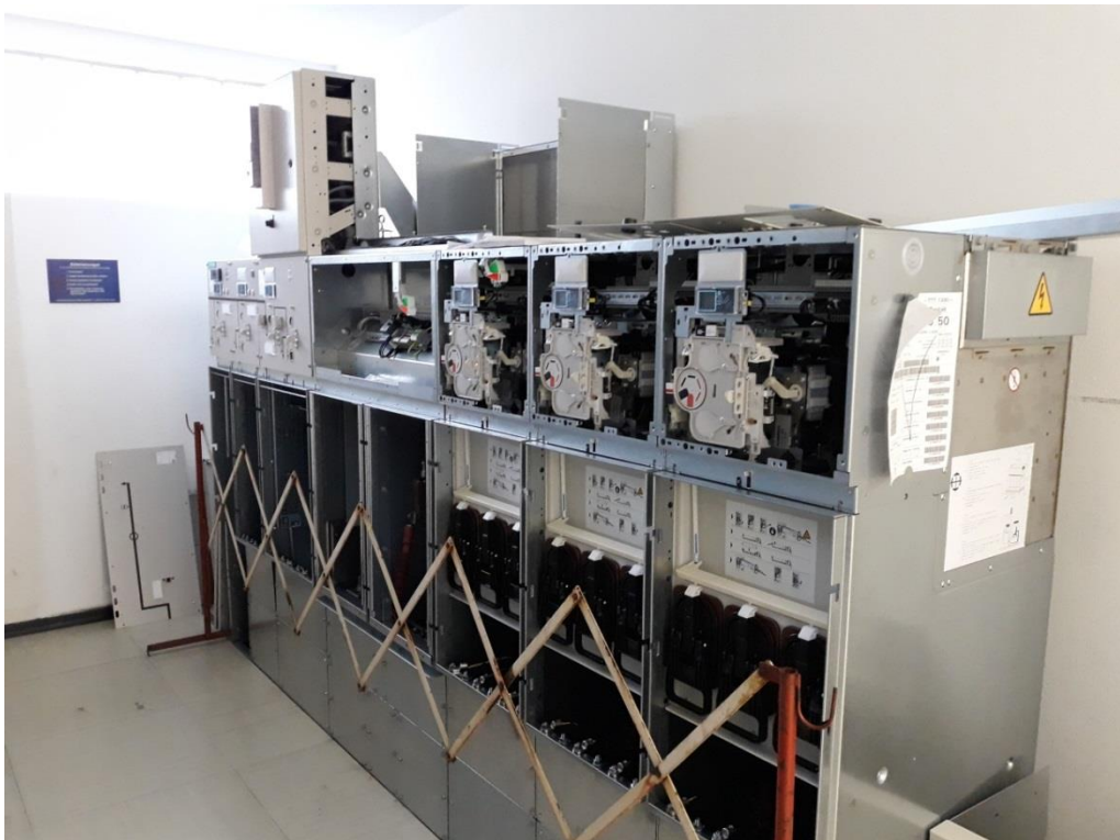
Neue Mittelspannungsschaltanlage (50 kV)
