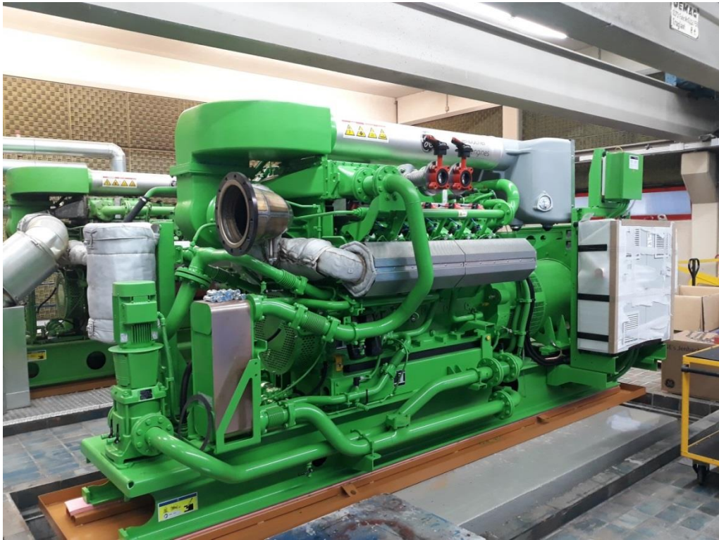
Neues Blockheizkraftwerk mit Generator (noch ohne Schallschutz)
