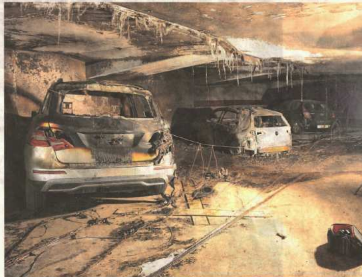
Im September 2014 brannte es in der Ravensburger Marienplatz Tiefgarage. In der Folge wurden massive Tauschschäden an den Stahlbetonbauteilen entdeckt, die Garage muss seither aufwendig saniert werden. Nach der Wiedereröffnung soll es dort auch Tankstellen für E-Fahrzeuge geben.
