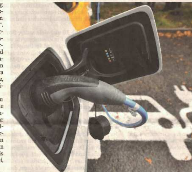
Ein Elektroauto „tankt“ an der Ladesäule Strom. 80 solcher Säulen sollen in die Tiefgarage unter dem Marienplatz eingebaut werden. Für Stadtrat Rolf Engler (CDU) Grund zur Sorge.
