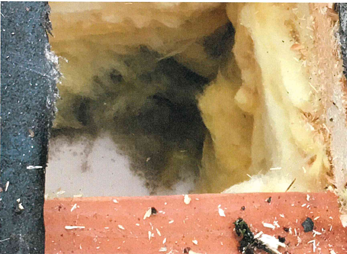
Dachaufbau unten: dampfdichte Schalungsbahn, raue Schalung, Glaswolle mit Schimmel = Feuchtigkeit am Dampfsperrenstoß
