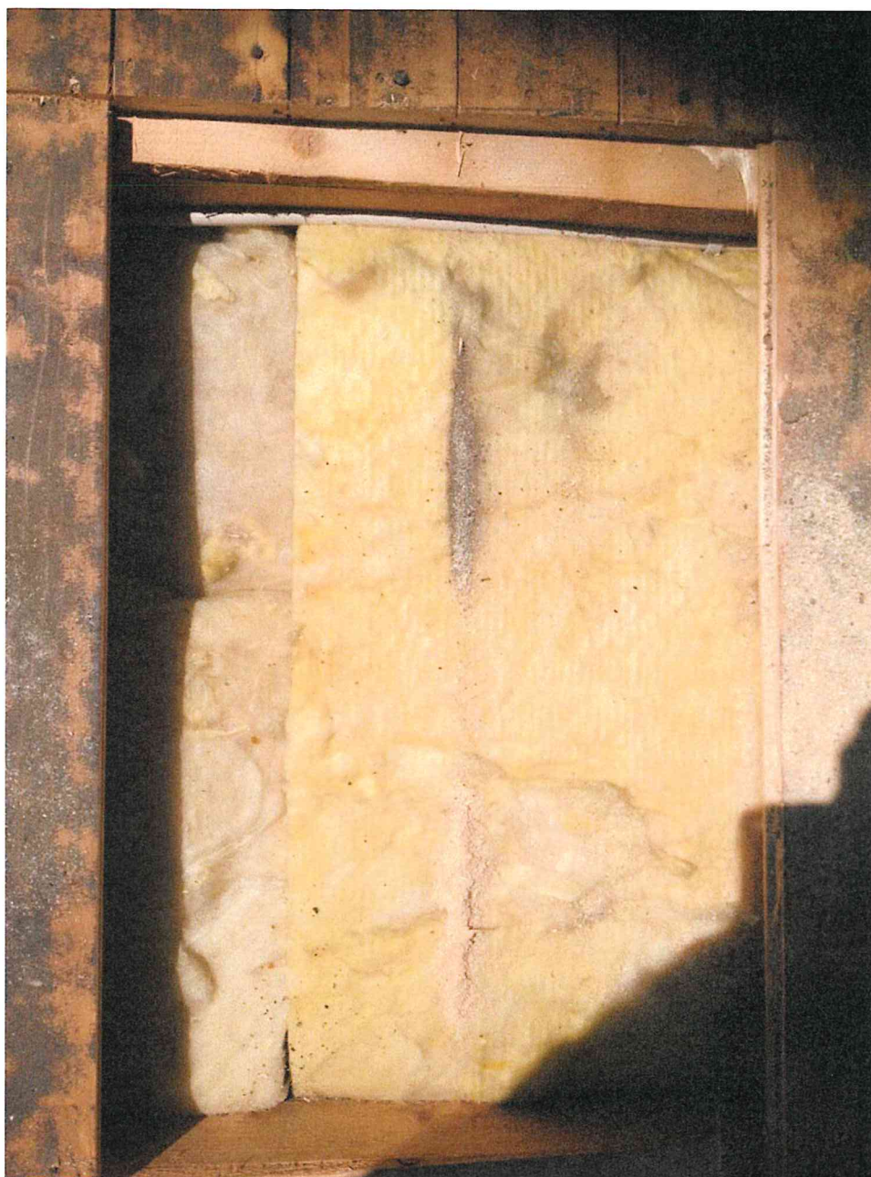
Geöffnetes Flachdach, Schimmel- und Feuchtespuren auf der Glaswolle
