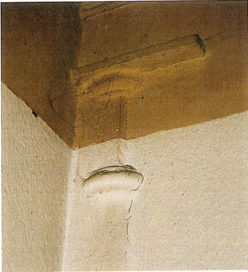
Abb. 1 Erdgeschoß. Gußeiserne Säule in der Südwand des südlichen Eingangsflures an der Westseite.
