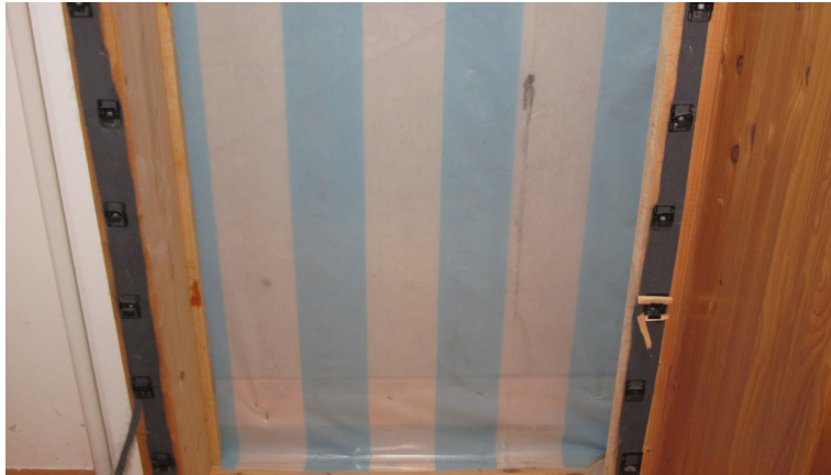
Bild 1: Dampfsperre ehem. Multifunktionsraum
