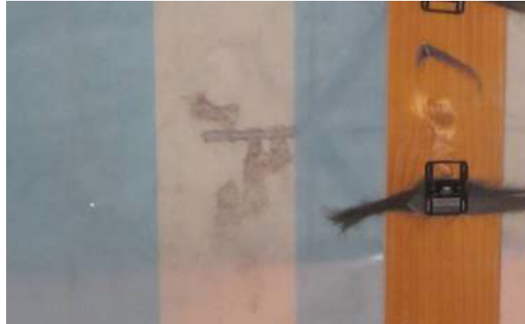
Bild 4: Dampfsperre ehem. Multifunktionsraum
