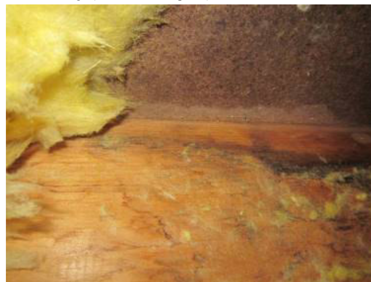
Bild 12: Öffnung 7 (starke Feuchtespuren)
