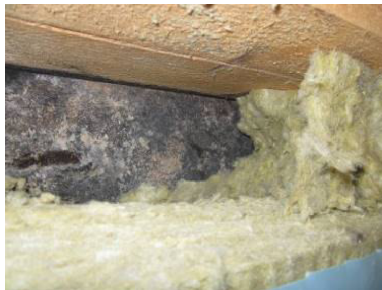
Bild 8: Öffnung 6 (starker Pilzbefall)
