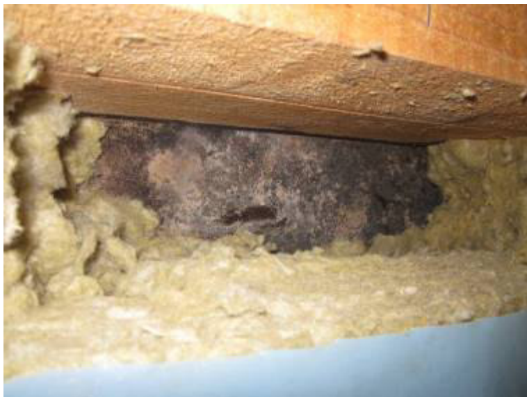
Bild 7: Öffnung 6 (starker Pilzbefall)
