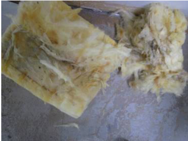
Bild 21: Öffnung 14 (Mineralfaser mit Pilzbefall)
