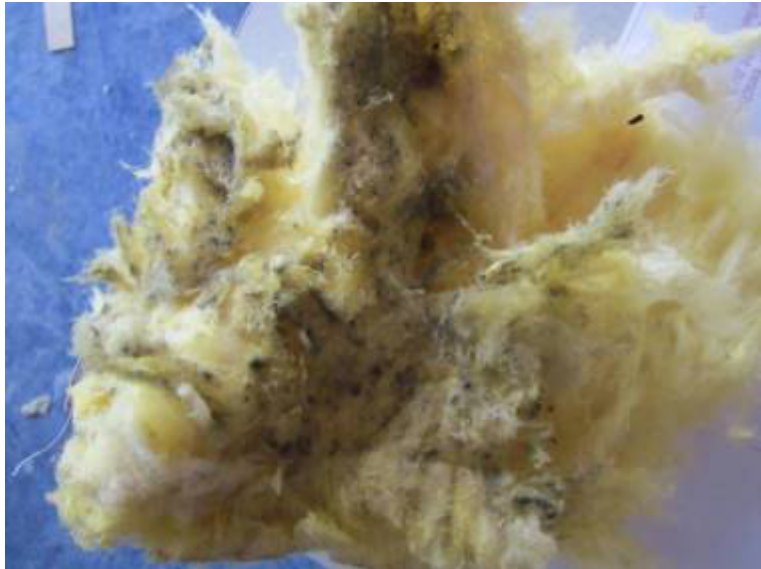
Bild 13: Öffnung 7 (Mineralfaser mit Pilzbefall)
