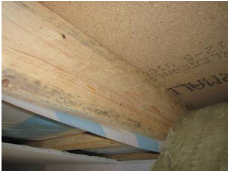
Bild 5: Öffnung 3 (Stockflecken am Balken)
