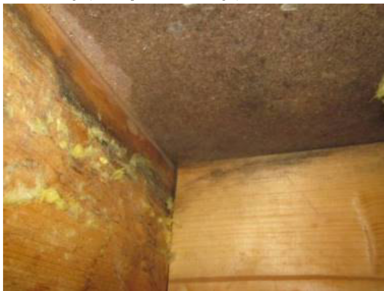
Bild 11: Öffnung 7 (starke Feuchtespuren)
