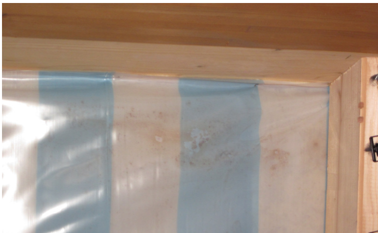
Bild 3: Dampfsperre ehem. Multifunktionsraum
