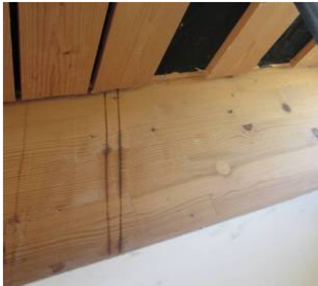
Bild 9: Öffnung 7 (Wasserspuren am HVB-Träger)
