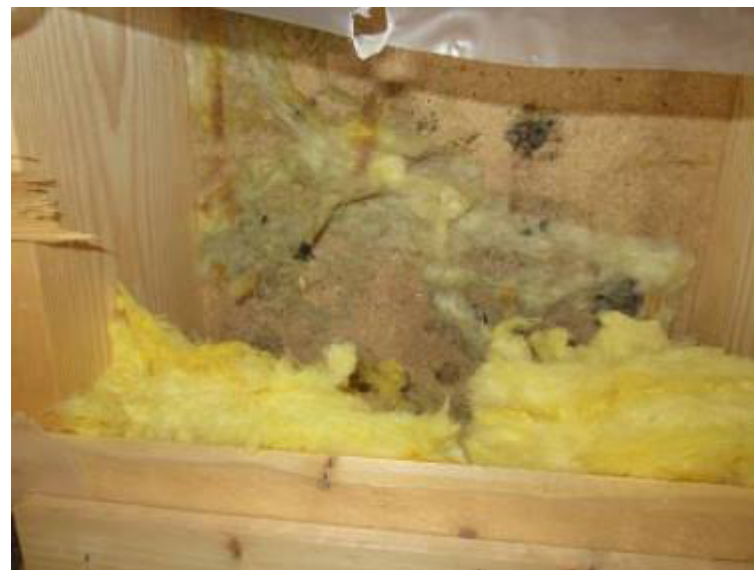
Bild 20: Öffnung 14 (Stockflecken auf Spanplatte)
