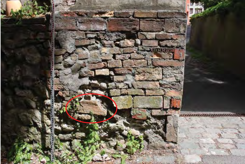
Foto_029: Nordmauer, Südseite, westlicher Bereich. Historische Backsteinverblendung der Kieselmauer. Markiert: Backstein lose
