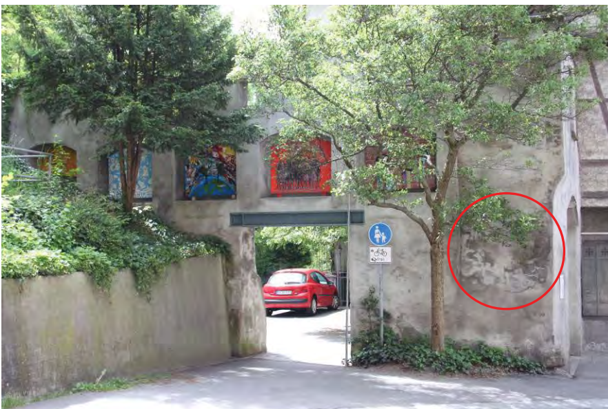
F_027: Nordmauer, Straßenseite. Umkreist: Spuren Staunässe unter dem Zementputz
