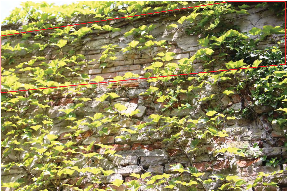
F_017: Nordmauer, Ansicht von Süden, aufgesetzter Mauerstreifen von 1865. Darunter: durchbindende Nischenbögen der Befundeinheit 03b.
