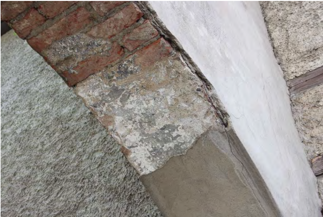
F_008: Torbogenmauer, Archivolte mit historischen Putz- und Fassungsresten
