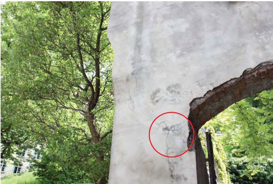
F_026: Torbogenmauer, Straßenseite. Umkreist: Risse im Zementputz, Schalenbildung
