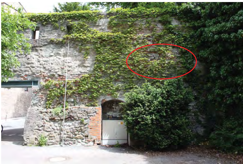
F_025: Nordmauer, Hofseite (Südseite). Auf Höhe der beiden östlichen (sich nach Norden öffnenden) Materialspar-Nischen ist die Mauer stark zum Hof hin gebaucht; die Fugen des Backsteinmauerwerks sind ausgewaschen. Grund ist eindringendes Wasser und Schub aus dem seit 1865 hier anstehenden Erdhang.
