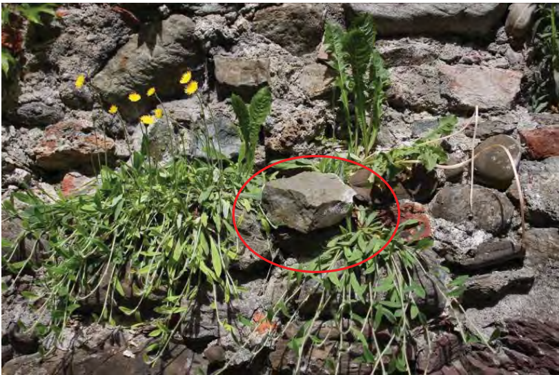
Foto_030: Nordmauer, Südseite, mittlerer Bereich. Unten: Kieselmauer, oben: aufgesetzte Nordmauer, Partie Mischmauerwerk. Auf dem Mauerrücksprung hat sich in den offenen Fugen Bewuchs gebildet; einzelne Steine sind losgesprengt (Kreismarkierung).
