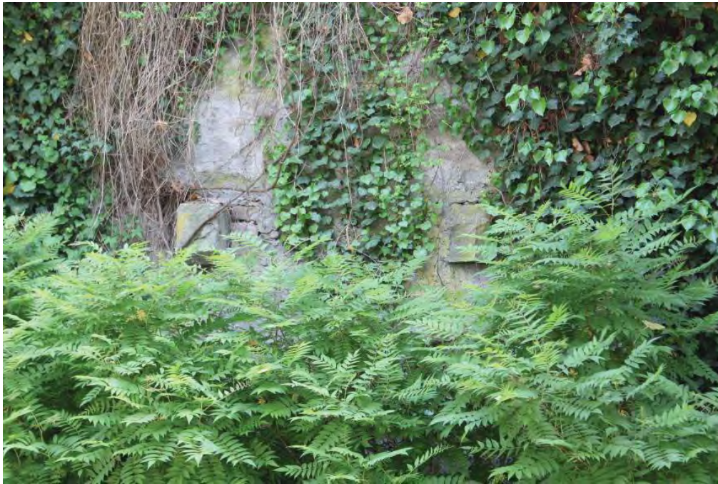
F_022: Hangmauer, Konsolen
