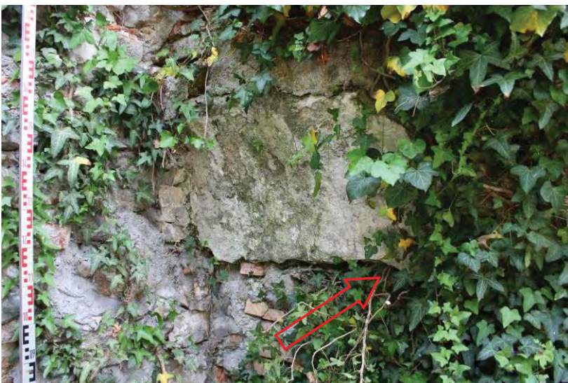
Foto_031: Innenecke Nordmauer-Hangmauer, Gewölbeansatz. Gewölbeauflager durch eindringende Wurzeln gesprengt.
