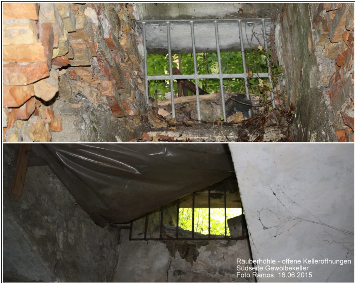
Abbildung 8 Gewölbekeller „Räuberhöhle“, Burgstraße 14, 88212 Ravensburg. Offene Kelleröffnungen (nur mit Gitter versehen). Vor der südöstlichen Öffnung (Foto oben) herrscht eine dichte Vegetation (Junggehölze mit Eschen u.a.). Foto: Ramos, 16.06.2015.
